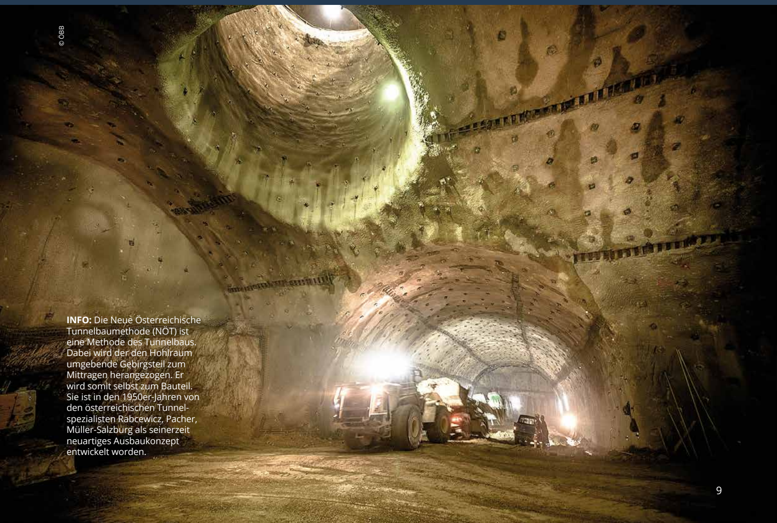
Schachtkopfkavernensystem in Göstritz
