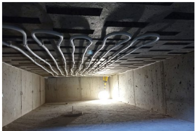
↑ Fußbodenheizung unterhalb des schlitzreduzierten Betonspaltenbodens
