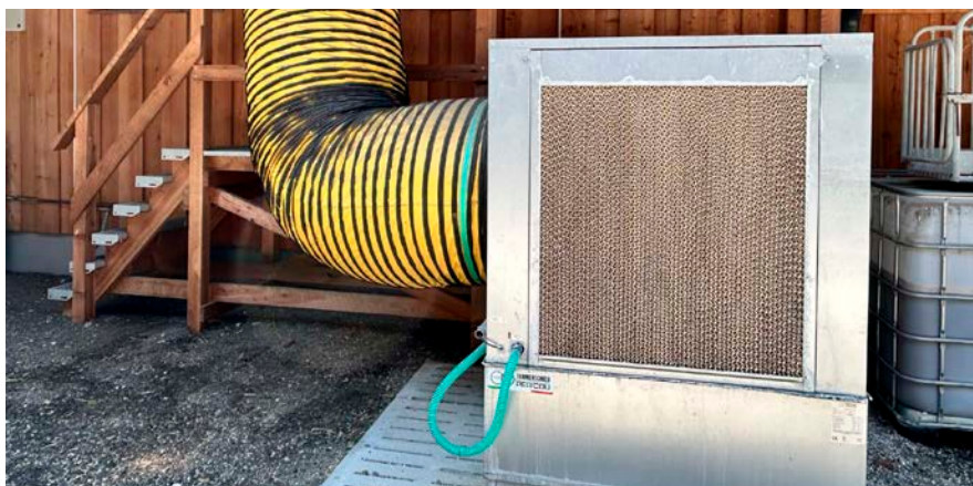
Nachgerüstetes Cool Pad zur Stallkühlung.
