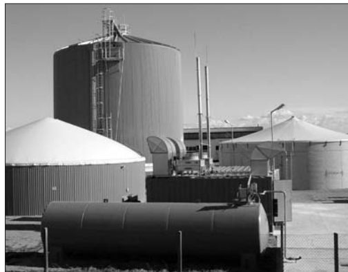
Ende 2001 gab es in Österreich 86 landwirtschaftliche Biogasanlagen, Ende März 2005 waren 159 Anlagen in Betrieb.
