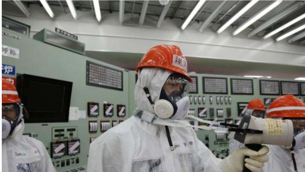
Eine TEPCO-Gruppe im zentralen Kontrollraum des Fukushima-Reaktor Nr. 1. Bild: Reuters
