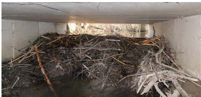
Abb.5.4. Blockierung des Abflusses durch einen Biberdamm in einem Brückendurchlass. ©G.Hölzler
