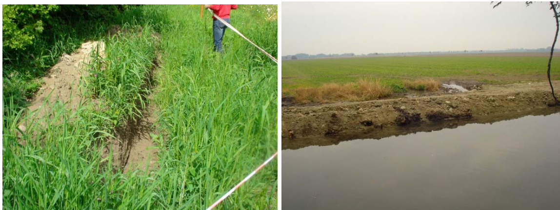
Abb. 6.2. Untergrabung der Berme an einem Hochwasserschutzdamm (li); der Wasseraustritt durch Biberröhren am Ufer des Gewässers vernässt zumindest randlich die unmittelbar hinter dem Uferdamm angrenzende Ackerfläche (re). ©G.Hölzler
