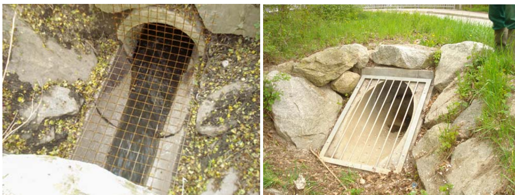
Abb. 5.7. Die Halbschale eines Rohrdurchlasses wurde mit Baustahlgitter abgedeckt (li) ©G.Hölzler. Das rechte Bild zeigt einen Rohreingang, der mit einem Schräggitter geschützt wurde. Angeschwemmtes Material wird hochgedrückt und kann den Durchlass nicht blockieren. Wenn das Gitter mit Scharnieren befestigt ist, können durch ein Hochklappen notwendige Reinigungsmaßnahmen leichter durchgeführt werden, ©F.Zeiser
