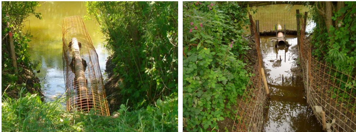
Abb.5.6. Anfangs ein langes Rohr mit einer Gitterhülle (li) an das ein weiterer Korb zum Schutz des Auslaufbauwerkes angebaut wurde (re). ©G.Hölzler
