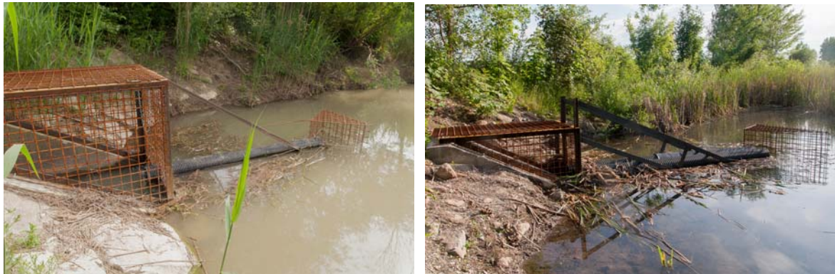
Abb.5.5. Zwei nahezu baugleiche „Beaver deceiver“ wurden an den Auslaufbauwerken von Retentionsbecken installiert. ©G.Hölzler
