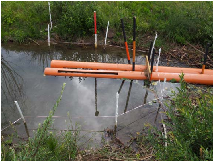
Abb.4.14. Übersicht zur Lage einer Dammdrainage in einem kleineren Bach. Es wurden zwei Rohre mit jeweils etwa 25cm großen Öffnungen eingebaut. Die Rohre liegen auf der Dammkrone und sind mit einem E-Zaun gesichert (dies soll den Biber von einer Überbauung der Rohre abhalten), die Verankerung erfolgt mit Pflöcken und einem quer stehenden Brett, das ein Aufschwimmen der Rohre verhindert. ©B.Schön.
