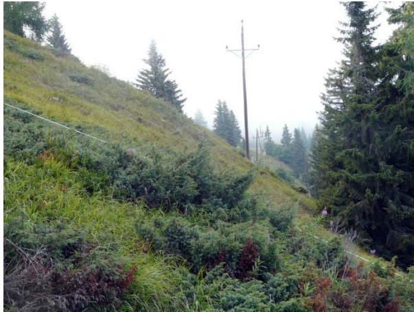
Abb. AIII-16: Erhöhtes Kollisionsrisiko bei Leitungsführung unterhalb einer Kuppe quer zum Hang; von links oben abfliegende Hühner, die einen Landeplatz im Wald rechts auf Höhe der Leitungskabel ansteuern, unterliegen einem besonderen Kollisionsrisiko.
