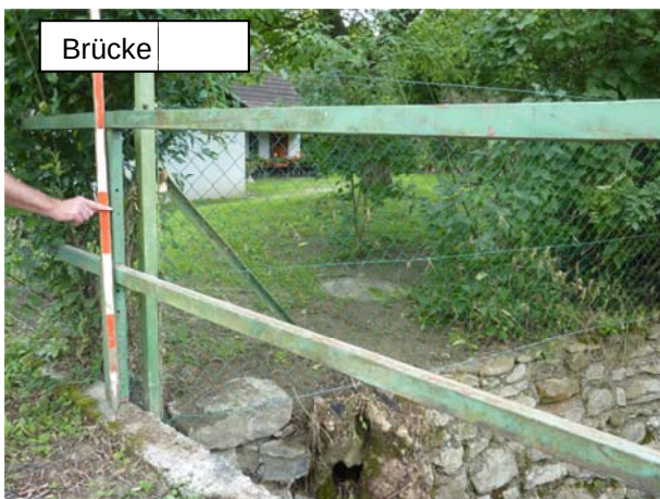
Foto zeigt eine Anschlagmarke am Wasserseitigen Geländer der genannten Brücke.
