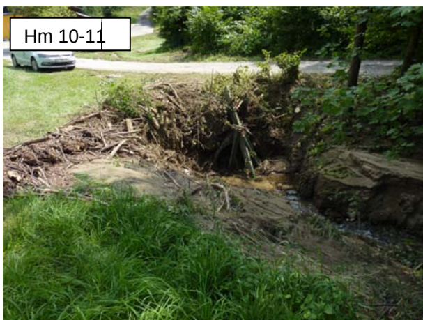
Foto in Fließrichtung: Im Ereignisfall verkleist Rohrdurchführung bei hm 10,7.
