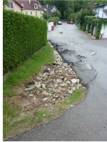
Foto in Fließrichtung: Unterspülung der Asphaltauflage in der Freiligrathgasse, gleich unterhalb der beginnenden Verrohrung.
