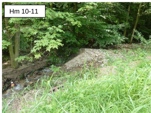
Das Foto zeigt Auflandungserscheinungen vor der Rohrdurchführung bei hm 10,7.
