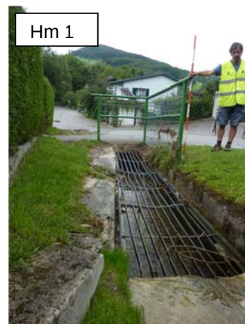
Foto in Fließrichtung: Kleiner Rechen vor Verrohrung beim Ereignis teilverklaust und überlastet.
