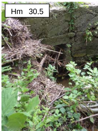
Verklausung beim Durchlass einer Zufahrtsstraße.
