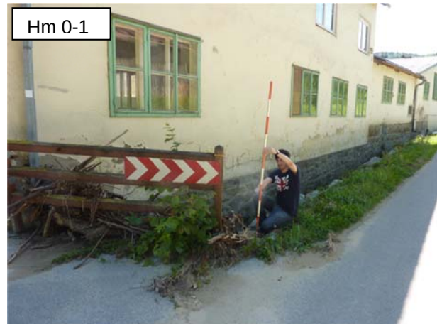
Foto entgegeng der Fließrichtung: Verrohrung bei hm 0,5 war teilverklaust.
