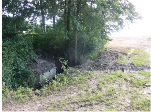
Verklausung bei einem Zubringer des Grubbaches oberhalb der Liegenschaft Grub 1.
