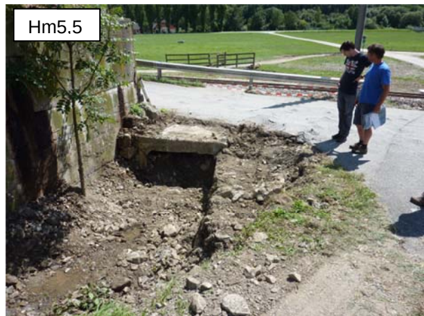
Foto in Fließrichtung: Gerinnedurchführung unter dem Zufahrtsweg zur Liegenschaft Mainburg 4.
