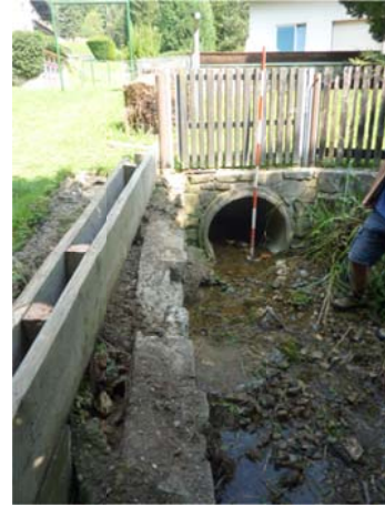
Foto entgegen der Fließrichtung: Rohrdurchführungen in der Schmiedsiedlung werden überlastet.
