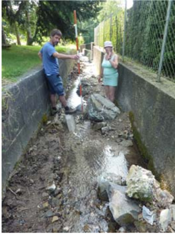
Foto in Fließrichtung: Gerinne im Zubringer in der Schmiedsiedlung zeigt teils Ablagerungen von grobem Material.
