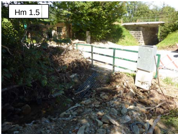
Wildholzrechen vor Verrohrung. Die im Hintergrund zu sehende Bahnunterführung wurde bis auf eine Höhe von 1,5 m eingestaut.
