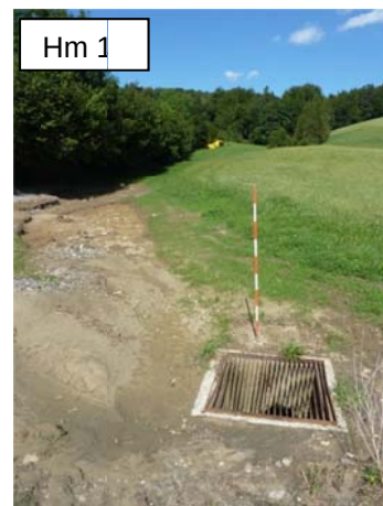
Schacht mit Gitter, in den die Verrohrung des Mitterfeldgrabens auf weitere Entwässerungsrohre stößt, bevor er unter der L110 Durchgeführt wird.
