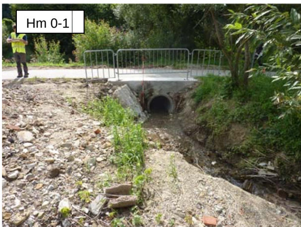
Foto in Fließrichtung: Der beim Ereignis völlig verklauste Rohrdurchlass vor der Mündung in den Stössingbach.
