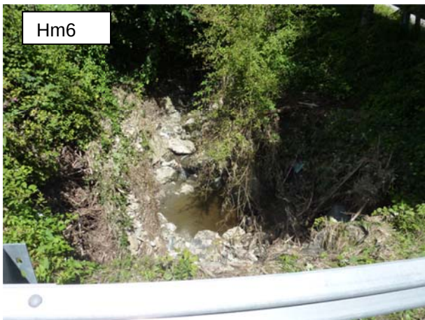
Foto entgegen der Fließrichtung: Rohrdurchführung blieb hier unverkaut, konnte jedoch den Ereignisabfluss nicht zur Gänze fassen.
