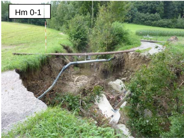
Foto flussaufwärts: Zerstörte Brücke an der Zufahrtsstraße zur Liegenschaft Steinabruck 42.
