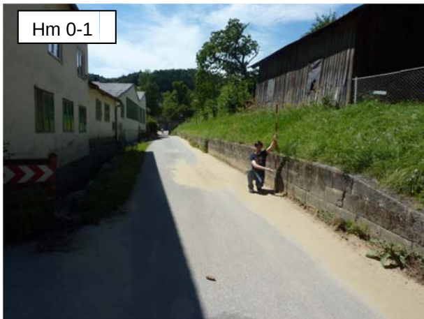
Foto entgegeng der Fließrichtung: Bild zeigt eine Anschlagmarke gegenüber der beginnenden Verrohrung am linken Bildrand.
