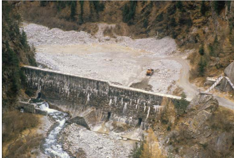
Abbildung 5: Klassische Geschiebestausperre am Fischbach im Ötztal (Foto: WLS-Archiv)
