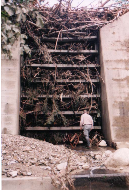
Abbildung 10: Verklaute Balkensperre am Trübenbach, Kärnten (Foto: WLW)
