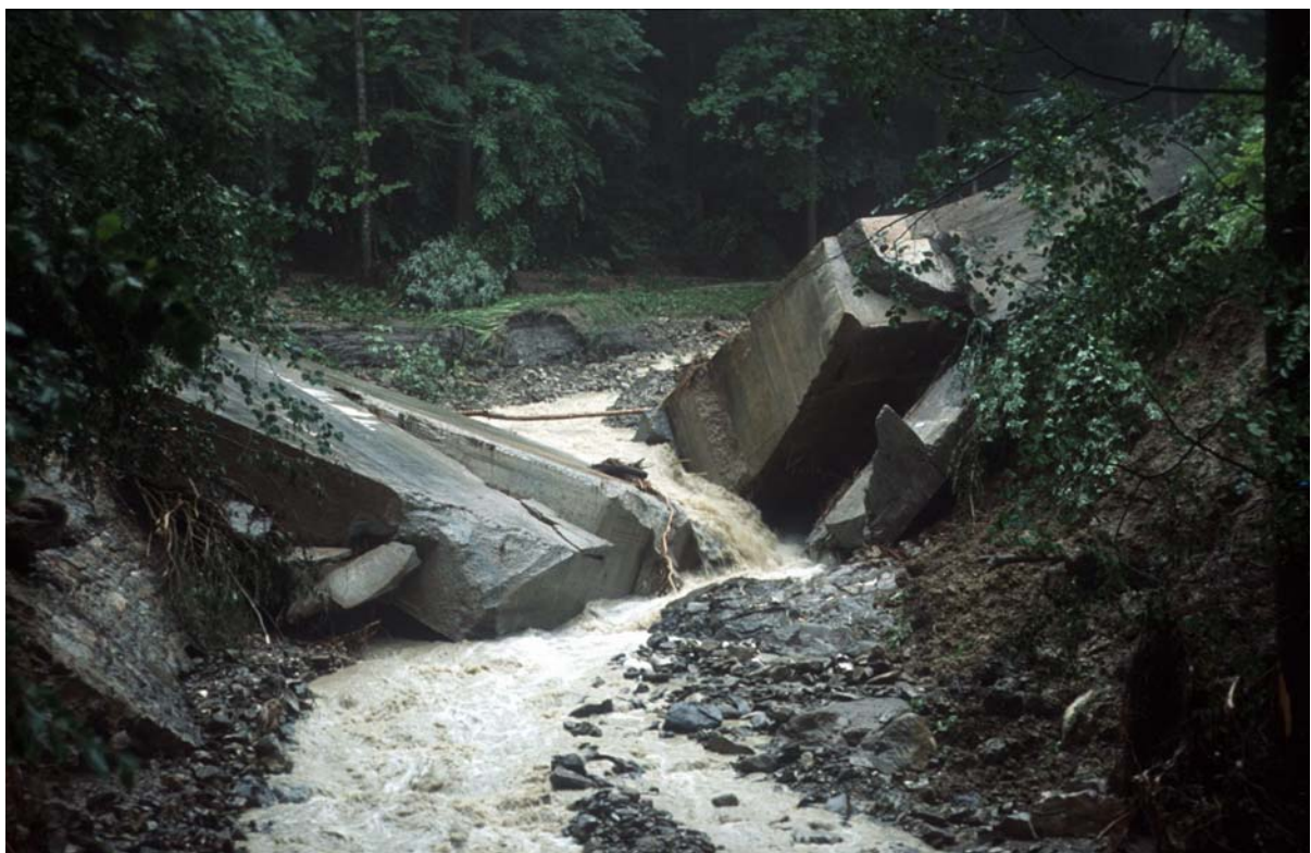
Abbildung 1: Gebrochene Sperre im Waldbachgraben
