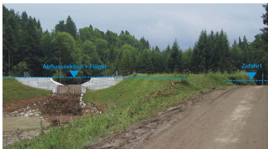
Abbildung 61: Situation um ca. 02:05 Uhr MEZ mit der hydraulisch beanspruchten Abflusssektion, der Sperrenflügel und dem Straßendurchlass
