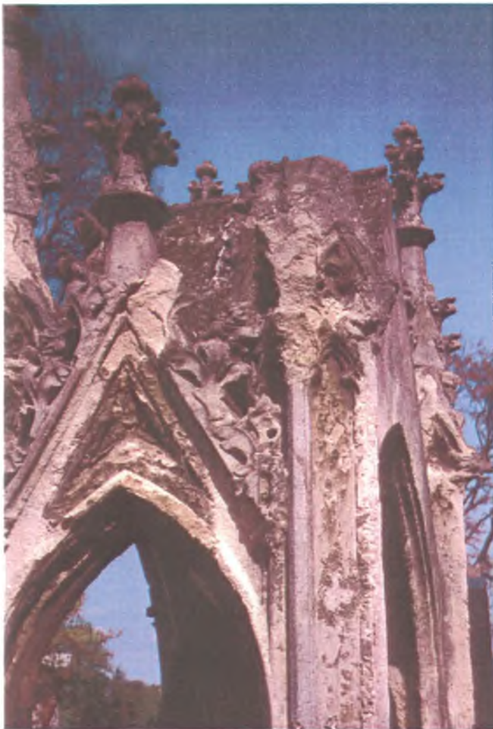
Abb. 1: Ein häufig zu beobachtender Zustand bei neogenen Kalksandsteinen sind Fehlstellen, Krustenbildung, Verschmutzung, Risse, etc. (neugotische Gruftanlage aus St. Margarethener Kalksandstein am Wiener Zentralfriedhof).
