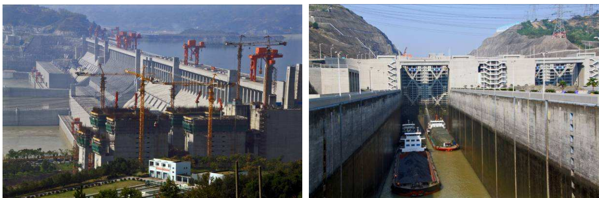
3-Schluchten-Sperre, Links unten: im Vordergrund das noch in Bau befindliche Schiffshebewerk und Rechts unten: der Blick in eine Kammer der fünfstufigen Doppelschleuse [18.10.2011]
