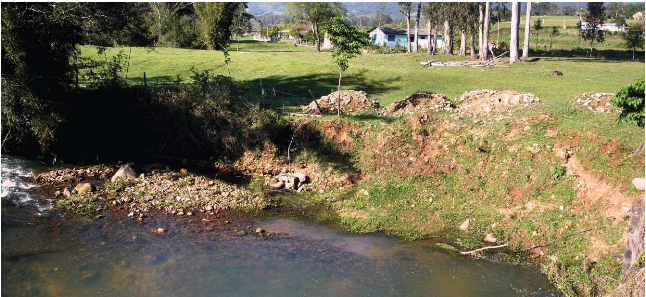
Abbildung 5.3.1.1: Erodiertes Gleitufer am Arroio Vale Vêneto, September 2005.
