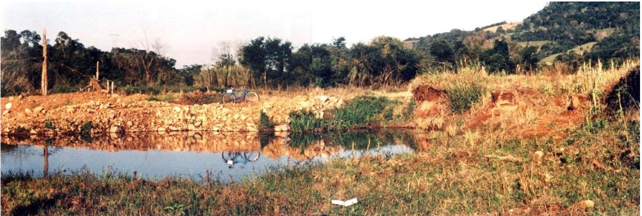
Abbildung 5.1.2.1: Böschungsanriss und Zufahrtsrampe zur Furt am Arroio Guarda-mor – Juli 2003.
