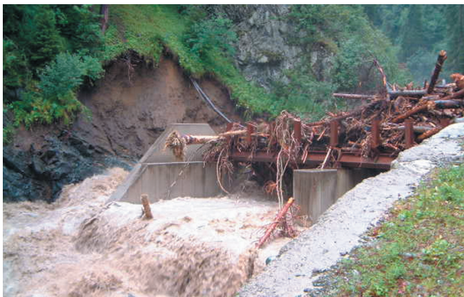
Bild 3: Beispiel für ein Versagen der Gebrauchstauglichkeit (Funktionsversagen) durch Verklauung der Abflusssektion und Umgehung des Bauwerkes; Foto: Walser Otto
