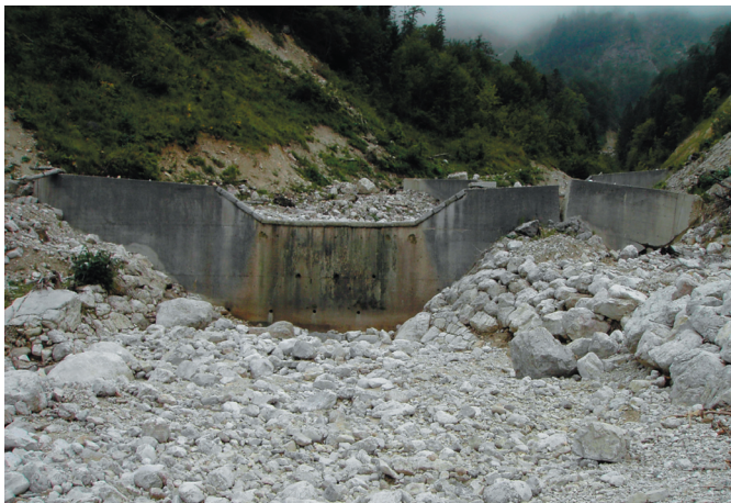
Bild 2: Beispiel für ein Versagen der Tragfähigkeit: Bruch im Flügel durch fehlende seitliche Einbindung (geotechnische R.) und fehlende horizontale Bewehrung (Bauwerkseigenschaft); Foto: Jürgen Suda
