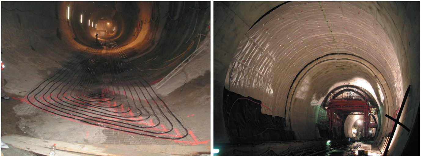
Bild 1: Anwendung der Tunnelthermie® für den bergmännischen Tunnelbau. Absorberelemente in einem U-Bahntunnel (U2/2, Energiebodenplatte) und in einem Eisenbahntunnel (Lainzer Tunnel LT 22-Bierhäuselberg, Energievlies) in Wien (Foto: J. Hofinger, R. Markiewicz).
