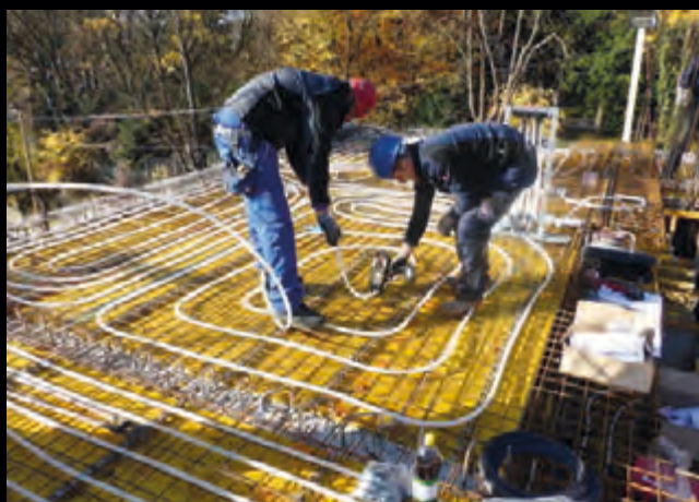
Die Beheizung oder Kühlung des Passivhauses erfolgt über thermisch aktive Stahlbetondecken.
