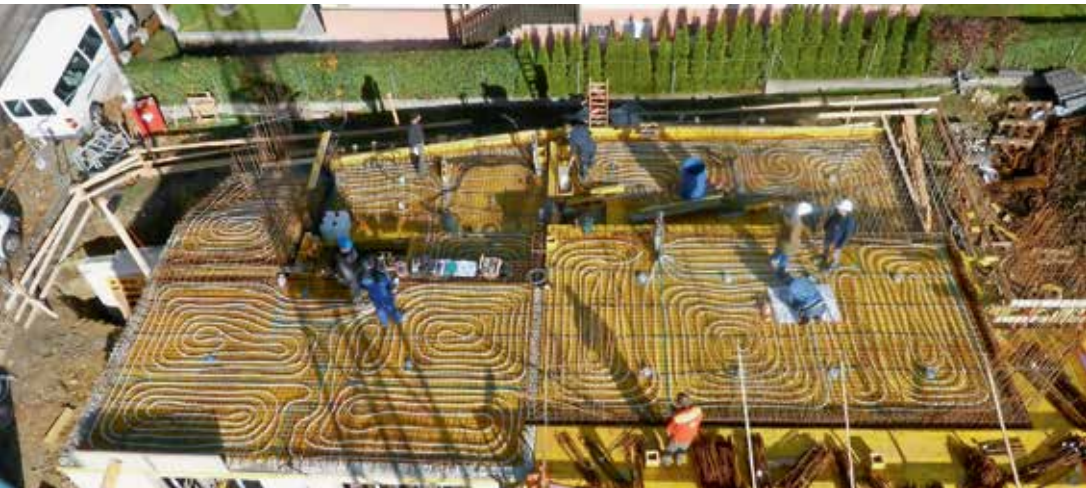
Der bauteilaktivierte Beton bietet viel Speichermasse für Sonnen- und Windenergie. TREBERSPURG & PARTNER ARCHITEKTEN
