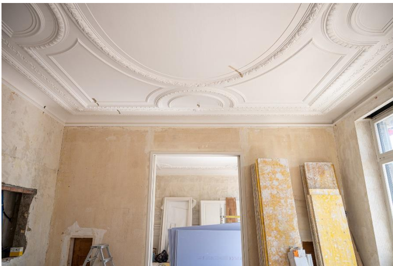
Abbildung 13: Stuckdecke im Zuge einer Wohnungsrenovierung (2)
